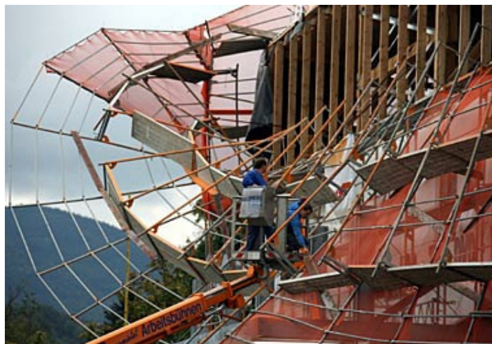
Freiburg: Mitarbeiter einer Gerüstbaufirma versuchen ein umgestürztes Gerüst aufzustellen. Foto: dpa/Seeger
